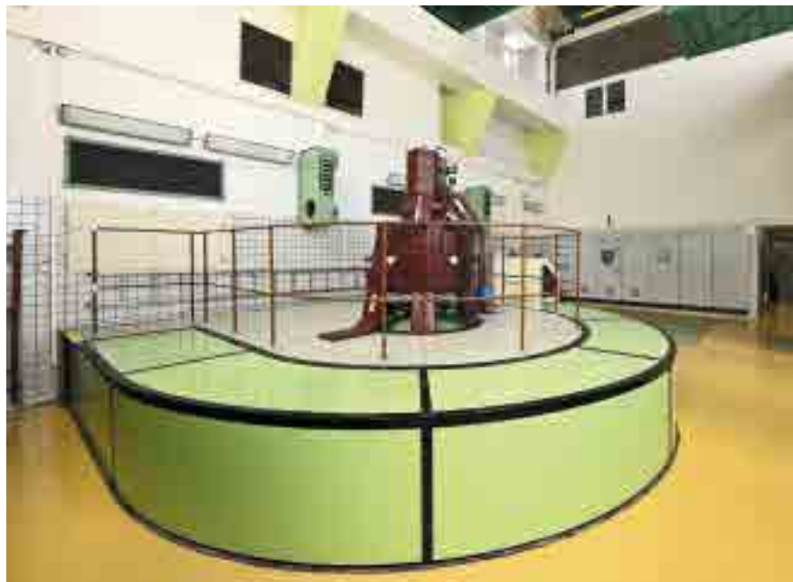
Im Wasserkraftwerk Lipno II wird im sog. Durchflussmodus, dh. kontinuierlich, Strom gewonnen
